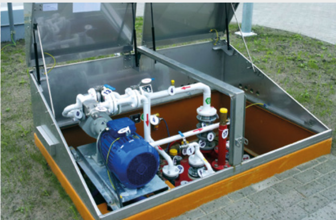
Projekt LPG-Modul an einer Tankstelle
